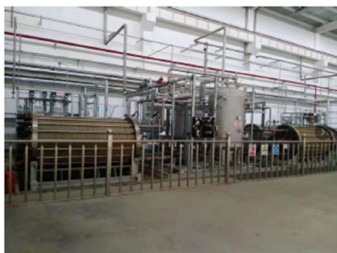
水电解制氢装置
